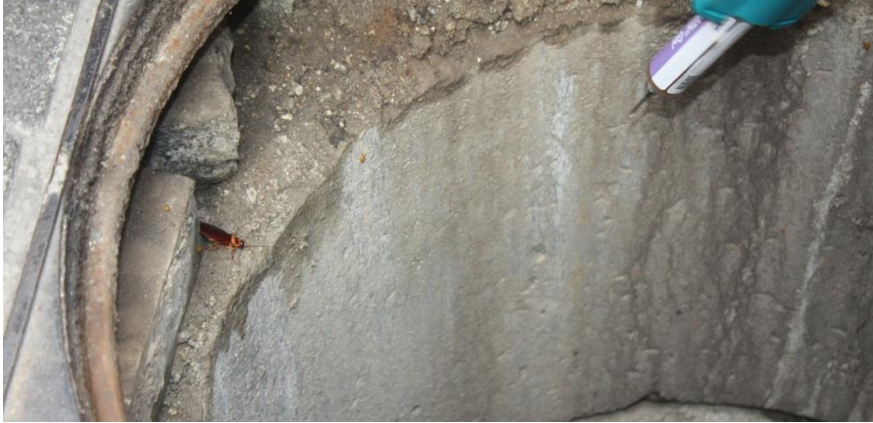
Kadıköy Çarşı'da yapılan pilot projede yer altı sistemlerinde Amerikan Hamamböceği tespit edilmiştir.
