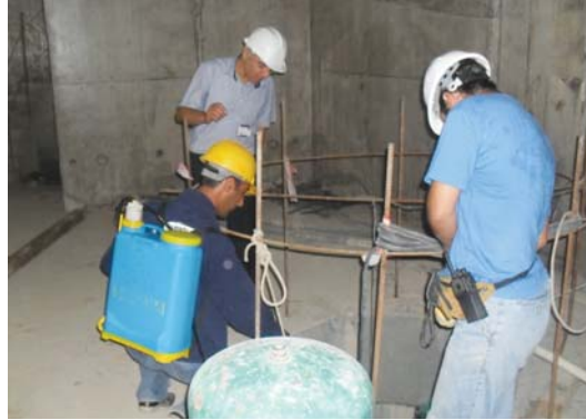
İnşaat Bodrum Sularında İlaçlama
